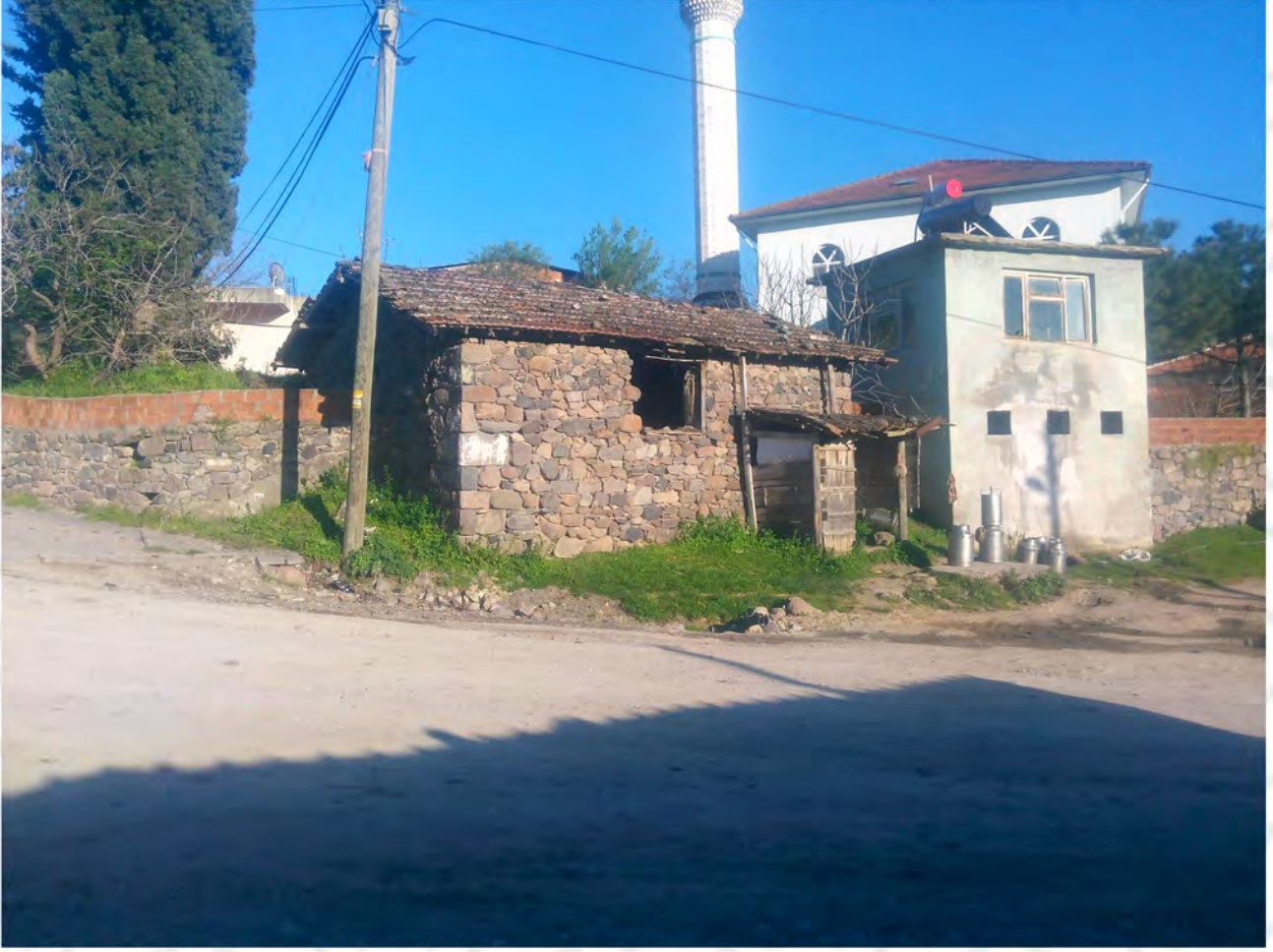
EYÜPBÜKÜMAHALLESİ TEHLİKELİ YAPI YIKILDI
