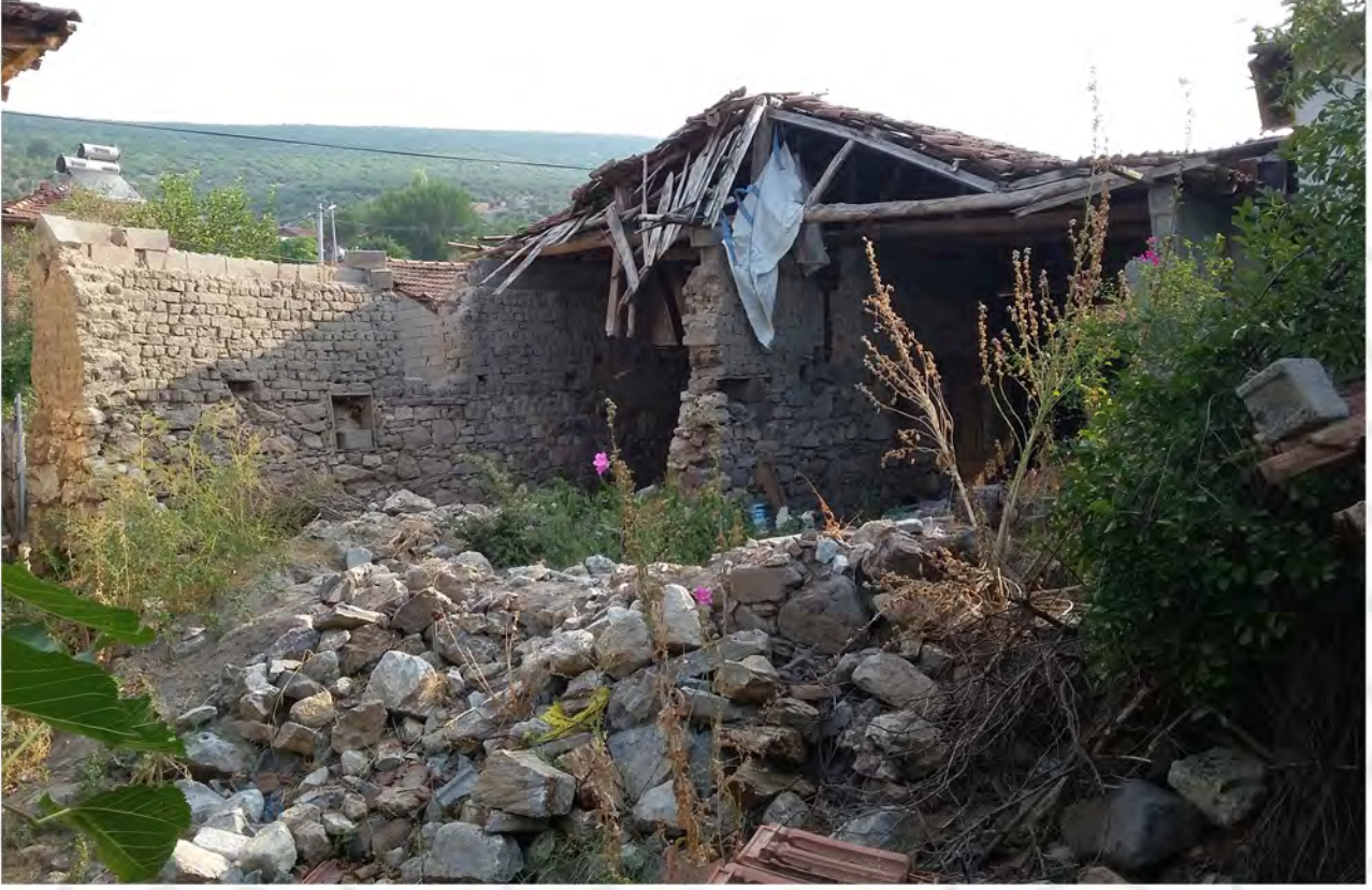
AKÇAKÖY MAHALLESİ TEHLİKELİ YAPI YIKILDI
