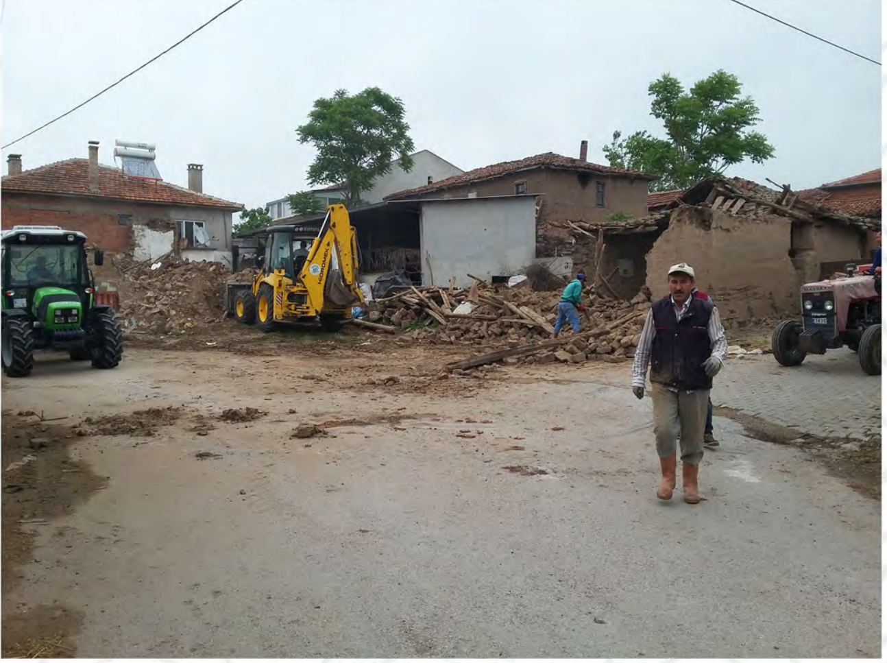
ŞEREMETLER MAHALLESİ 2 (İKİ) TEHLİKELİ YAPI YIKILDI
