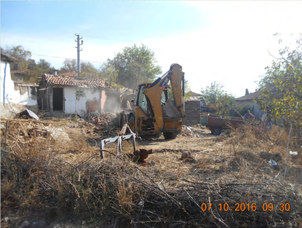
SERVET MAHALLESİ TEHLİKELİ YAPI YIKILDI
